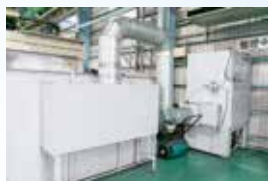
① 集塵機本体・配管ダクト
